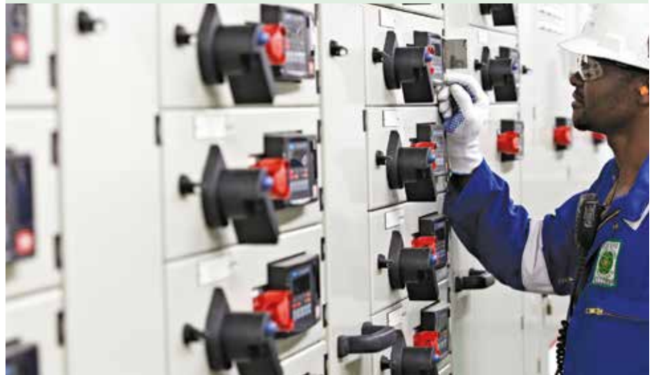
Técnico em serviço na sala de electricidade no FPSO Grande Plutónio.
