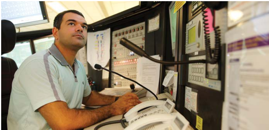
▲ Şahdəniz platformasında nəzarət otağının operatoru proseslərin monitorinqini aparır.
