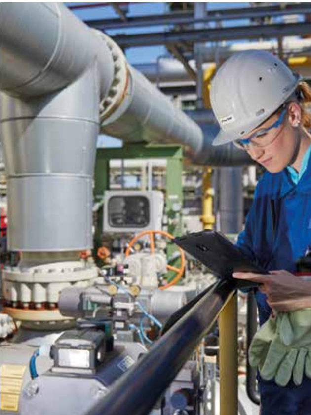
Der Einsatz digitaler Geräte gestaltet den Arbeitsalltag in der Raffinerie effizienter und sicherer.
