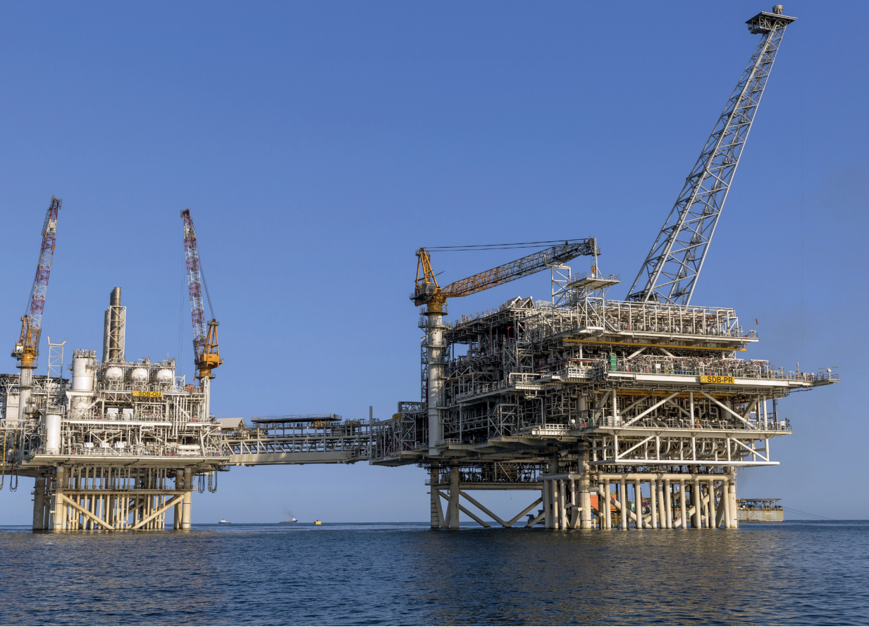
“Şahdəniz-2” layihəsi çərçivəsində dənizdə quraşdırılmış “Bravo” platforması
