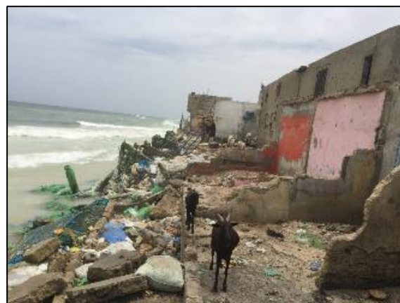
Photo 4-48 Maison détruite sous l'effet de l'érosion à Guet Ndar
