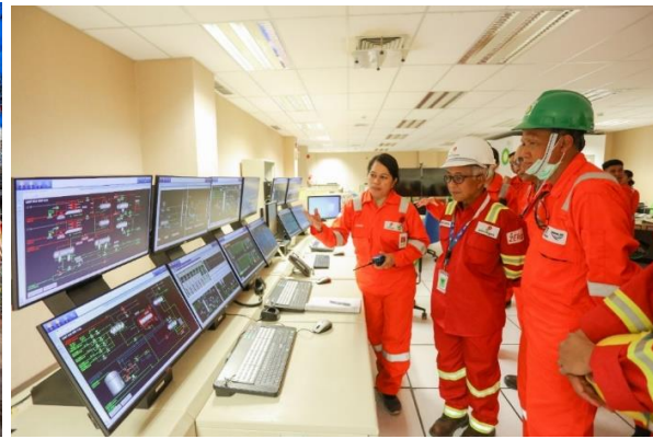
Main control building di area produksi Tangguh
