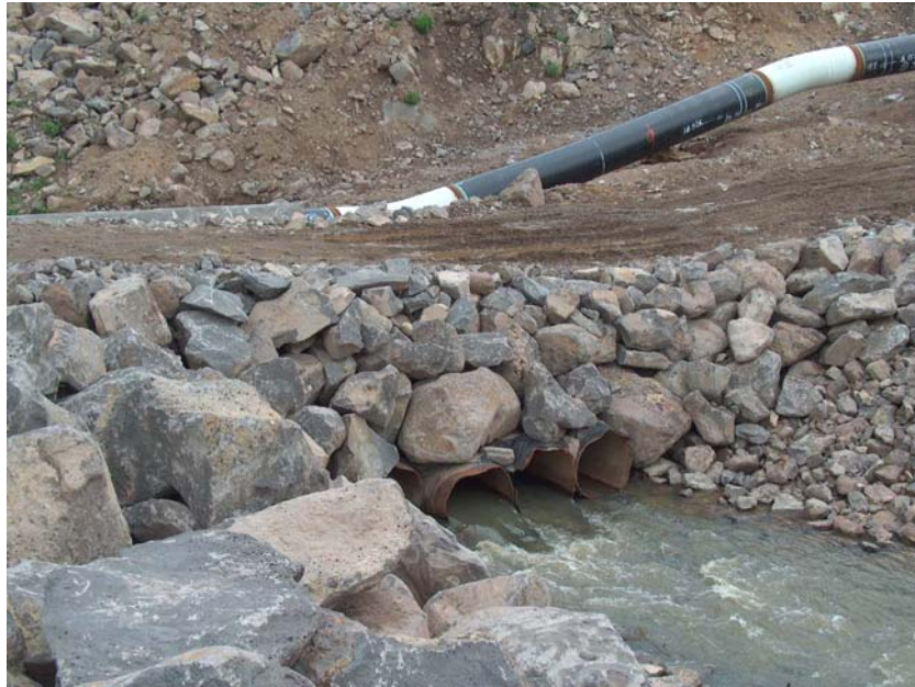
სურათი 13. KP-85 მდ. ჭივჭავის კვეთა. უკანა ფონზე მოჩანს გაზის მილსადენი, რომელიც უნდა დაიმარხოს. ნავთობსადენი უკვე ჩადებულია.
